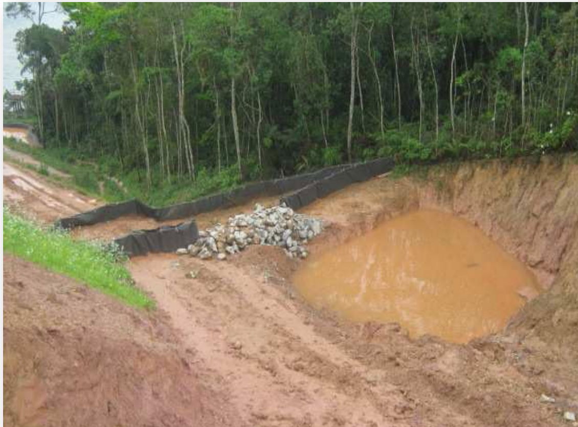
Bacia de retenção de sedimentos.
